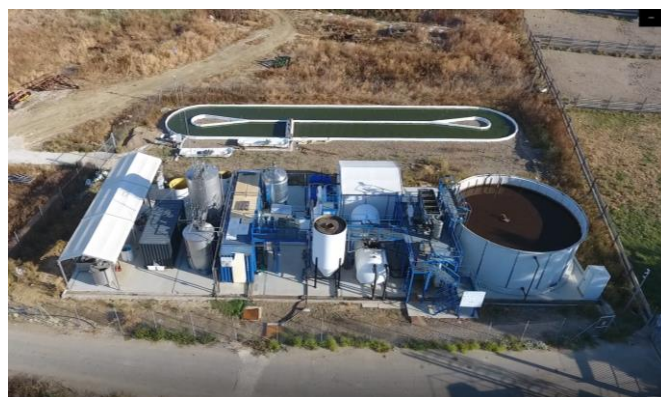
Fig. 16: Sistema Water2REturn en Matadero del Sur
