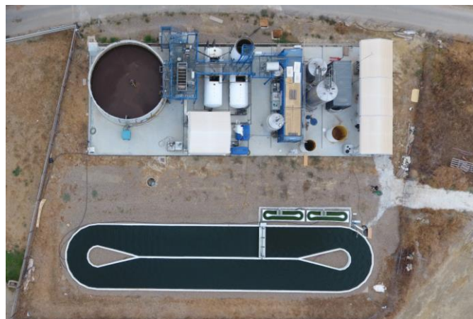
Fig. 15: Sistema Water2REturn en Matadero del Sur
