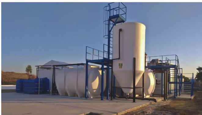
Fig. 12: Espesador de Water2REturn
